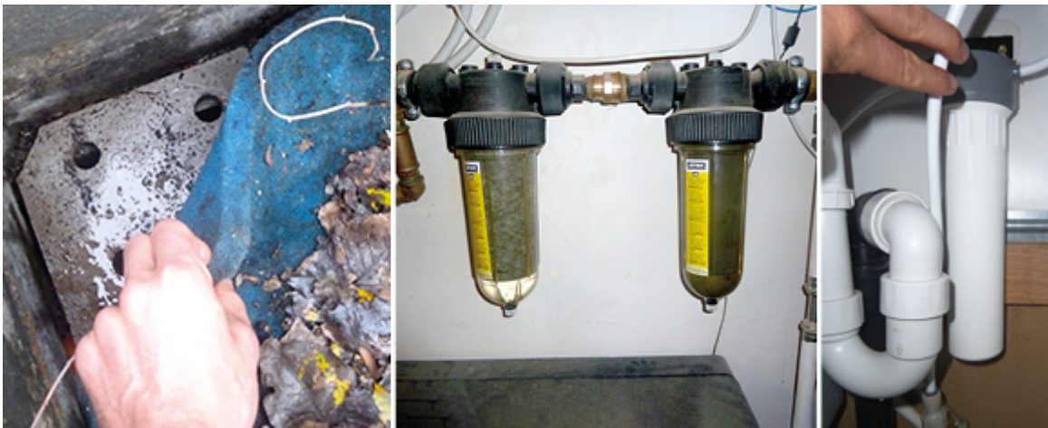
Les filtres pour l'eau de pluie.
